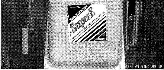
Sta 8 Pump D – 60 Hp
